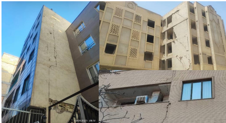
شکل ۱۲. شواهدی از تأثیر فرونشست زمین در آپارتمان‌های مسکونی در مرکز شهر ورامین
